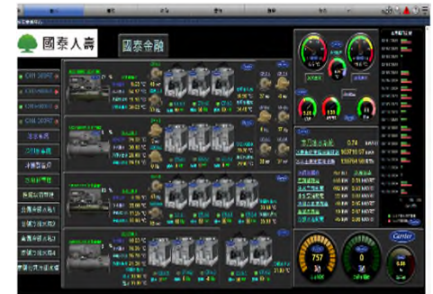
開利ALC空調監控系統
