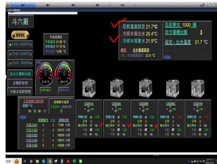
開利ALC空調監控系統
